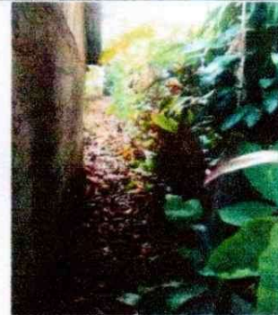
Foto 2: SE PUEDE VER LA PARTE TRASERA DE LA ESCUELA DEL MODULO 1 L=42.10 M (MAMPOSTERIA DE BLOCK)
