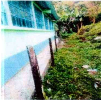
Foto 1: SE OBSERVA EL LADO DERECHO DEL MURO PERIMETRAL DEL MODULO 1 L=26.10 M (MAMPOSTERIA DE BLOCK)
